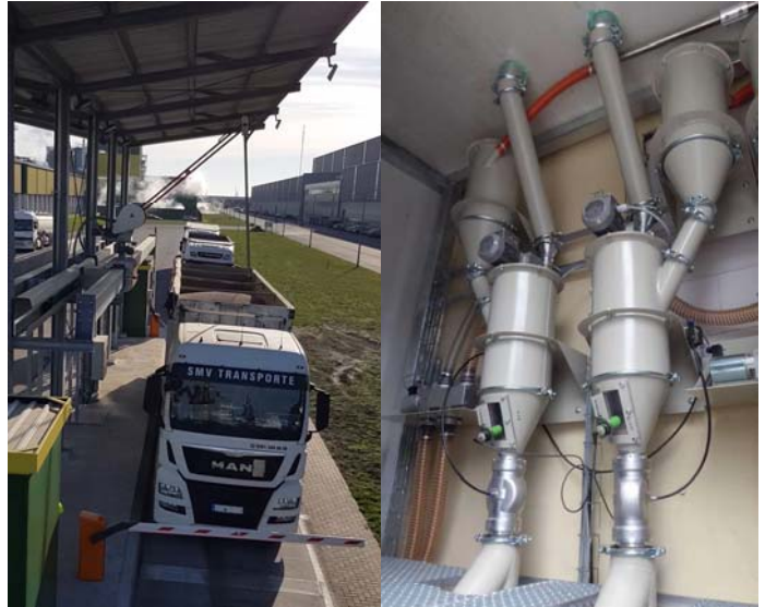
Abb. 6/7: Realisierter Wareneingang mit Fahrer-anmeldung und Probenahme / Probenaufbereitung im Laboranbau
